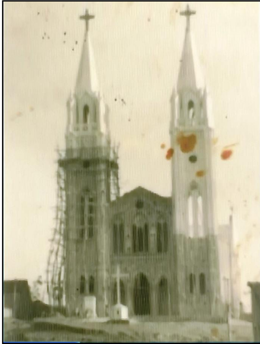
Figura 9 - Igreja Matriz, já com as duas torres construídas, começa a ganhar os acabamentos.
