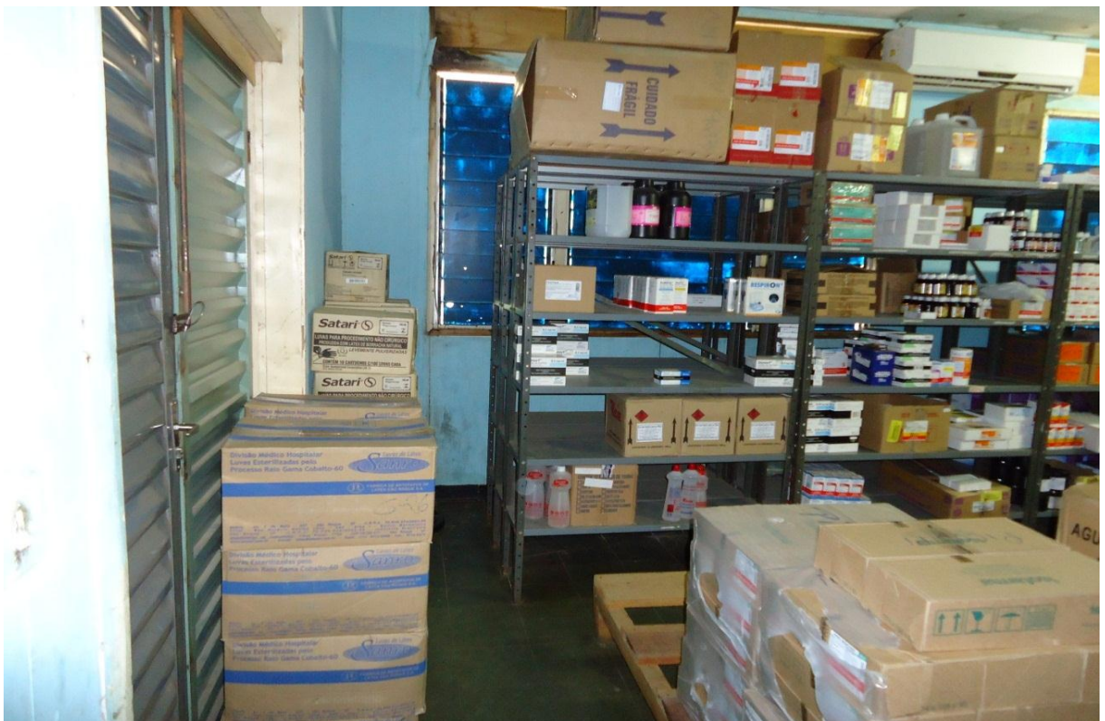
Figura 9 - (Problema 6) Indícios de infiltrações nas paredes.
