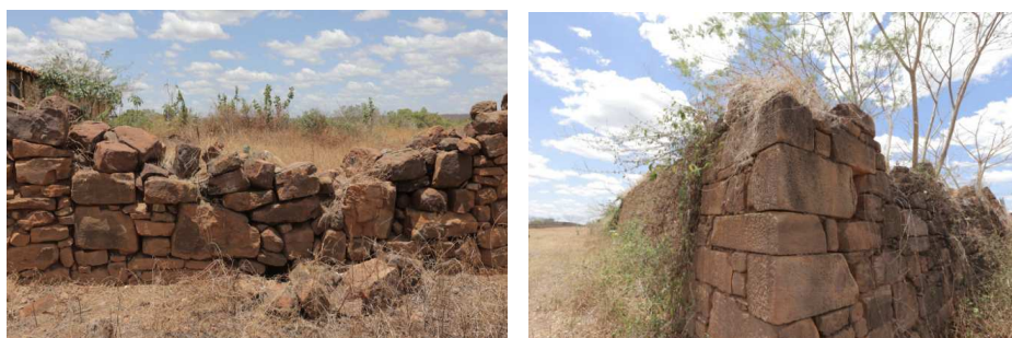
Figuras 2, 3, 4, 5 – Muros de pedras em ruínas da Fazenda do Serra Negra
